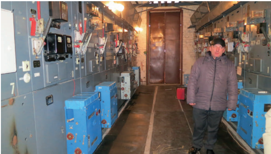
Krasnoarmiyska WTP indoor 6kV switch gear
