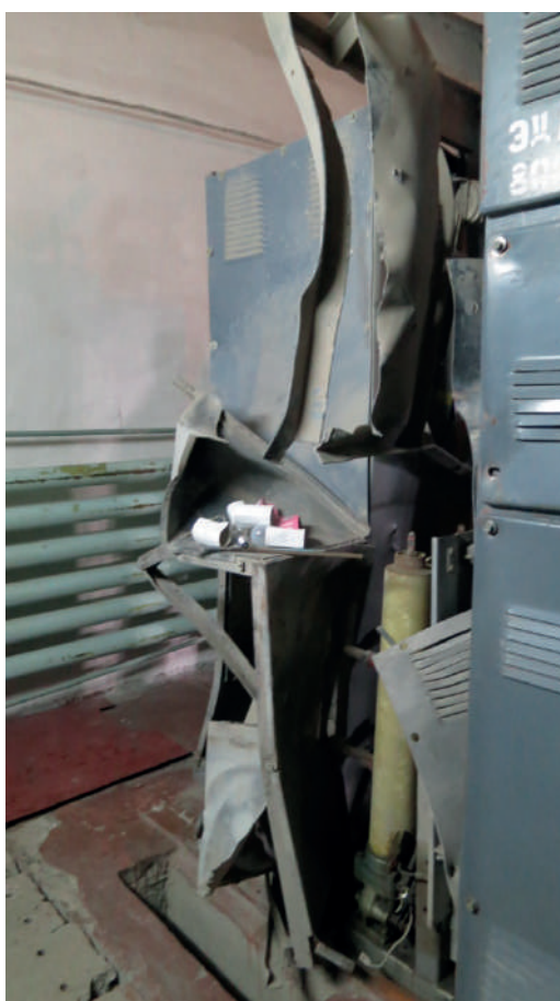
Елемент вимикача внутрішньої установки потужністю 6 кВ, пошкоджений у результаті обстрілу
