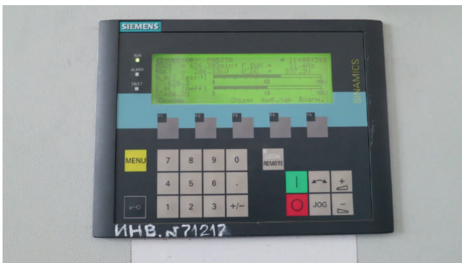
Новий перетворювач частоти, встановлений у 2013 році
