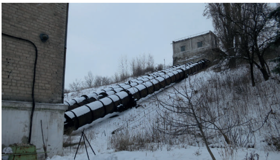
Магістральні труби після Насосної станції 4
