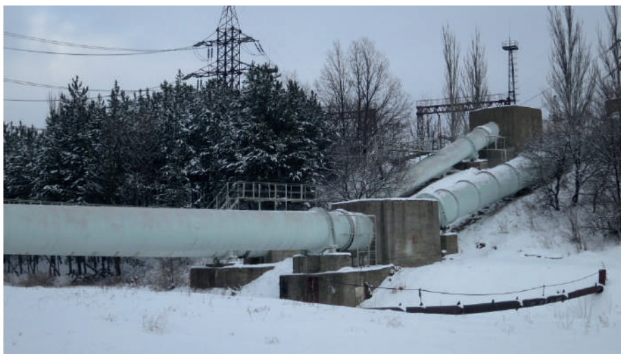
Магістральні труби після Насосної станції 3А
