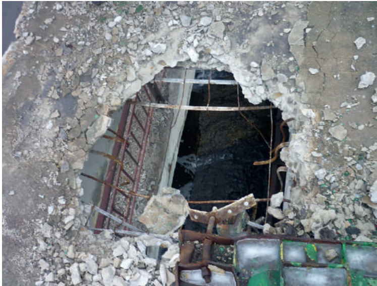
Пошкодження Карлівської водозливної споруди Красноармійської фільтрувальної станції, нанесені в результаті обстрілу
