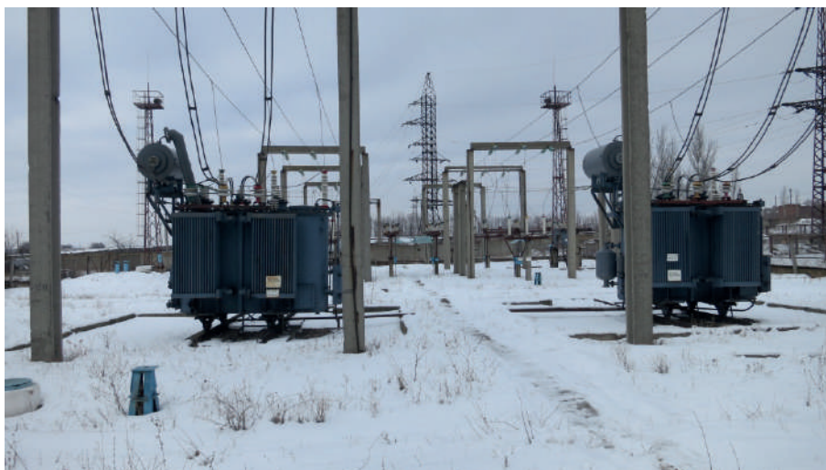
Основний трансформатор потужністю 35/6 кВ відкритої підстанції на Горлівській фільтрувальній станції 2
