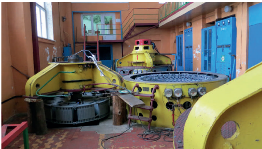
Машинний зал 4 ої каналізаційної насосної станції, секція № 2, демонтований двигун
