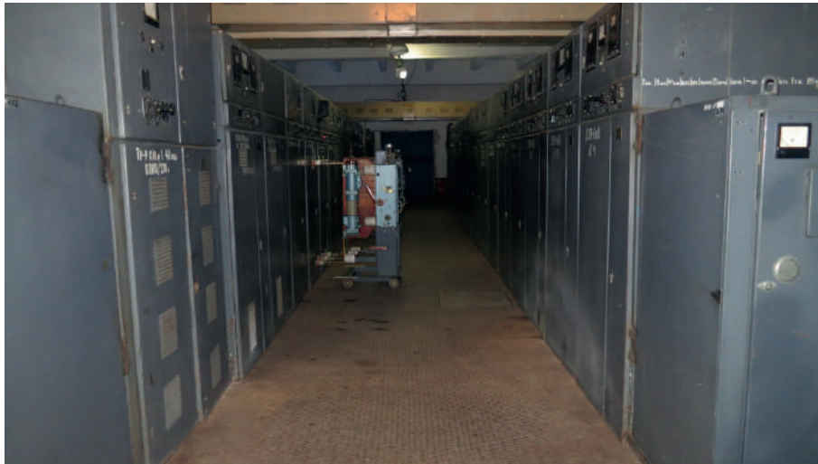
Закритий розподільчий пристрій потужністю 6 кВ на Слов'янській фільтрувальній станції 1
