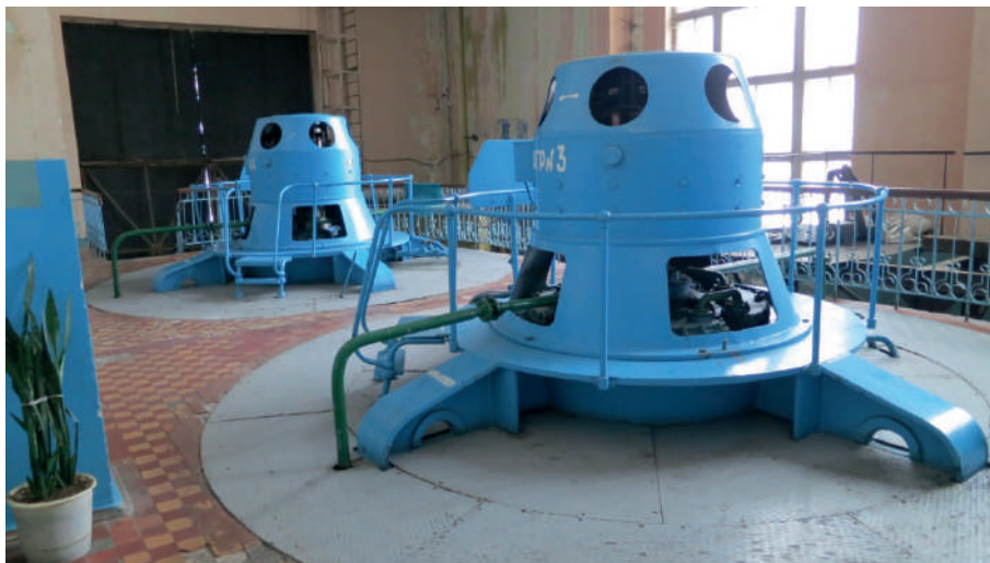
Насосні агрегати № 3 + 4 Насосної станції 3
