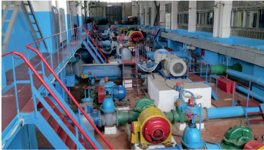
Машинний зал Макіївської фільтрувальної станції
