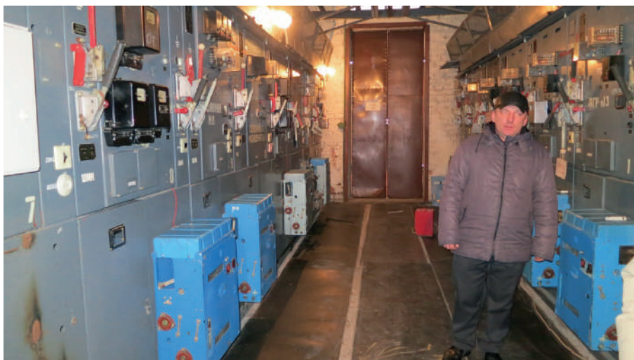
Закритий розподільчий пристрій потужністю 6 кВ на Красноармійській фільтрувальній станції
