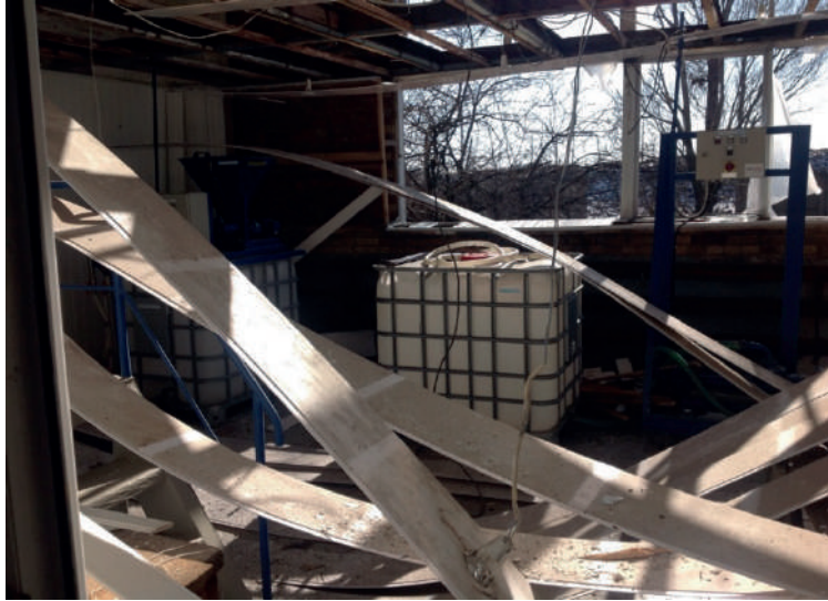
Пошкоджена будівля хімічного відділення Донецької фільтрувальної станції
