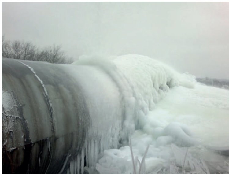
Зруйнований трубопровід каналу Сіверський Донець - Донбас взимку в районі Горлівки
