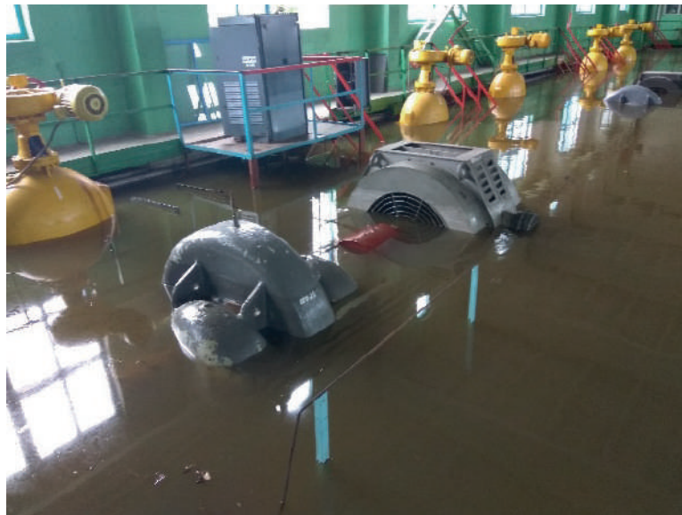
Затоплення 2 ї каналізаційної насосної станції каналу Сіверський Донець - Донбас в результаті нетипових експлуатаційних умов
