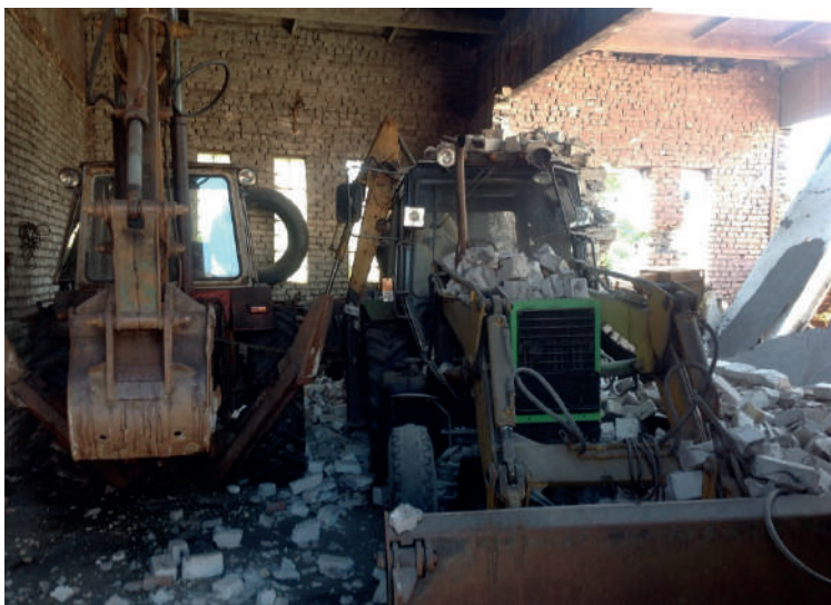
Пошкоджена будівля сховища аварійно-ремонтної техніки і власне пошкоджена техніка Донецької фільтрувальної станції
