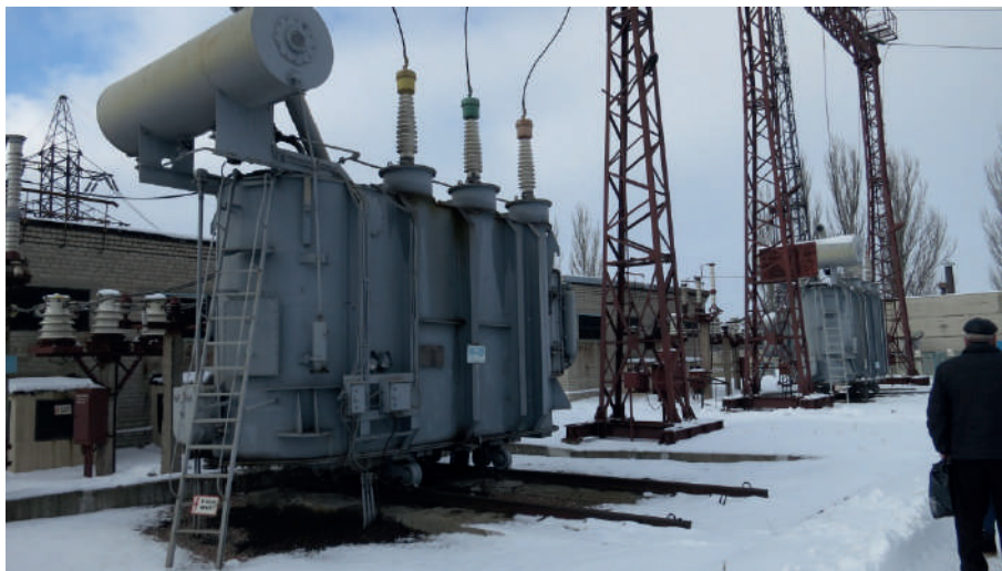
Основні трансформатори на підстанції 3 ої каналізаційної насосної станції СДД
