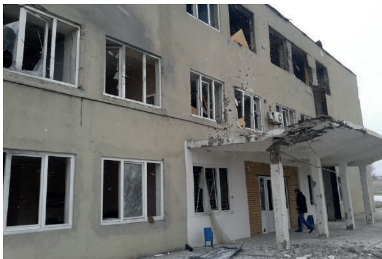
Пошкоджений фасад адміністративного офісу та лабораторного корпусу Донецької фільтрувальної станції
