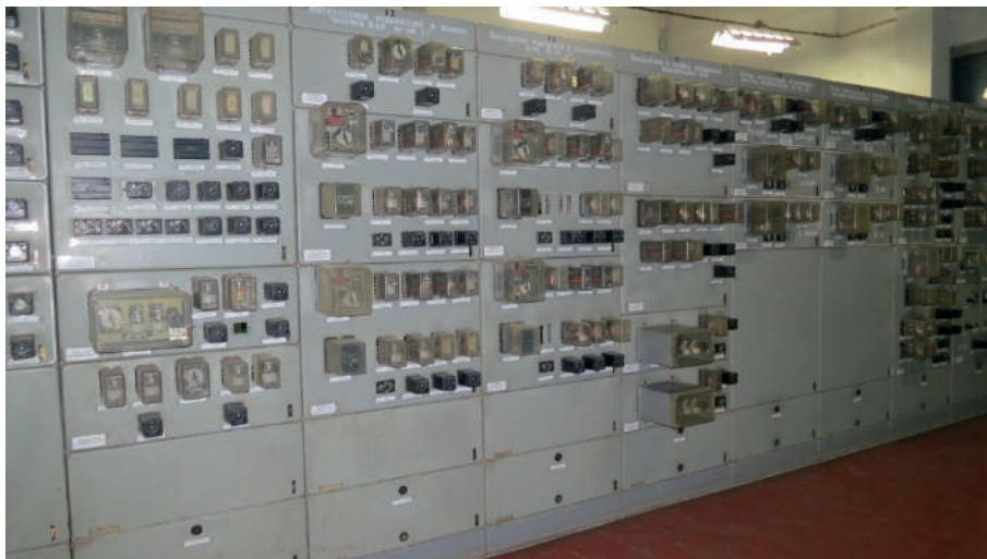
Пристрій релейного захисту на Слов'янській фільтрувальній станції 2
