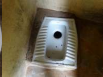
Pour flush toilet
