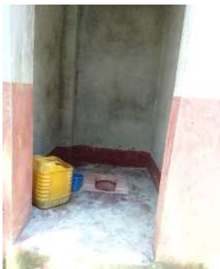
Picture 3: Flush pour toilet
