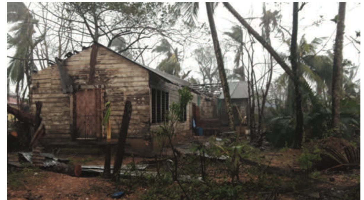
Foto: Inundación causada por huracán IOTA. Nicaragua. 2020.
