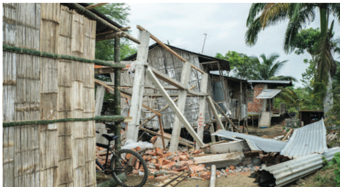
Foto: Daños causados a edificios por terremoto que afectó Manabí, Ecuador. Media Bank de Plan International. 2016.
