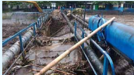
GAMBAR 11 BANJIR BANDANG MERUSAK SALAH SATU PIPA DISTRIBUSI UTAMA 7
