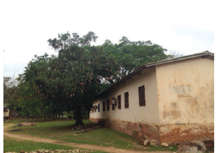
Centre d'Éducation à l'Environnement et au Développement (CEED) à Pita, dans un état de grande vétusté.
