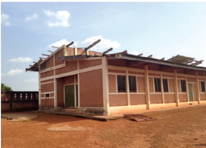
Toit de l'école écroulé suite à une tempête, Nongoa
