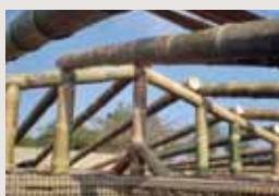
Construcción con adobe reforzado y bambú, como estructura de cubierta, con PUCP.
